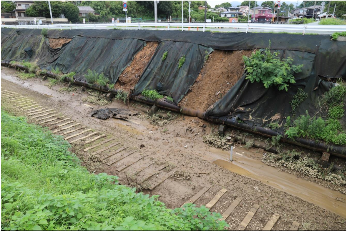
三池炭鉱専用鉄道敷跡 被災状況写真
