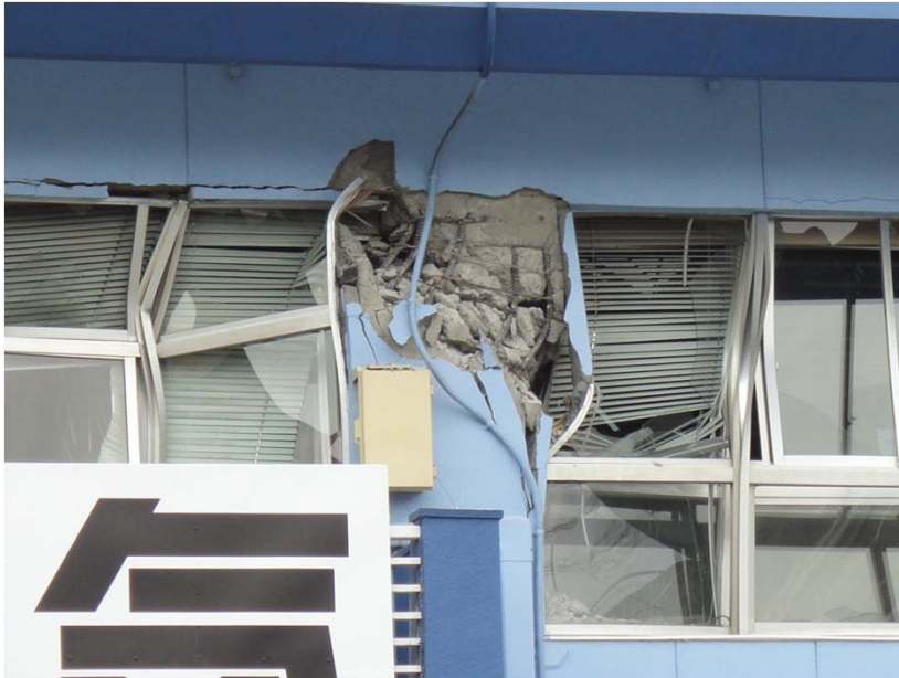
鉄筋コンクリート造り建物柱の破壊
