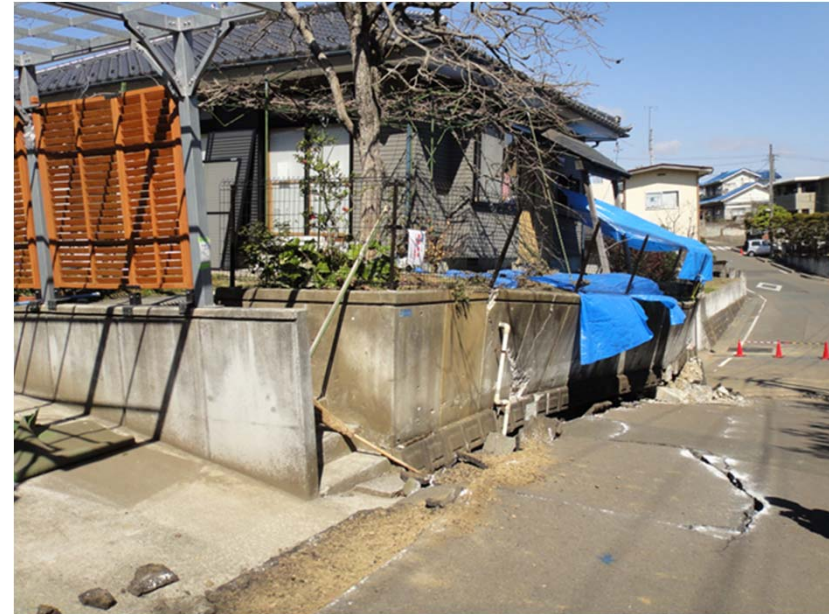
住宅の地すべり
