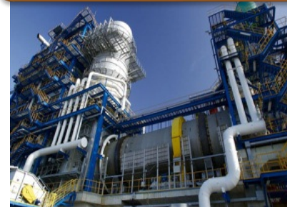
廃棄物発電施設
