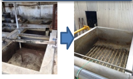
既存の排水処理槽
