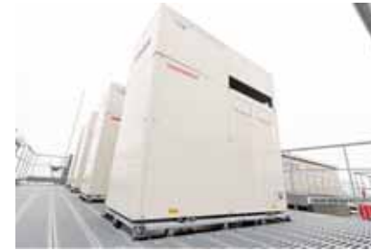
停電対応型ガスコージェネレーションの活用例
