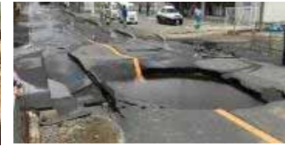
地震による管路の被災状況
