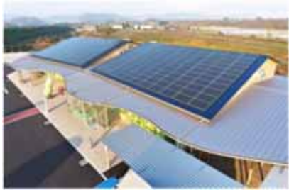
避難施設に設置した太陽光発電設備
