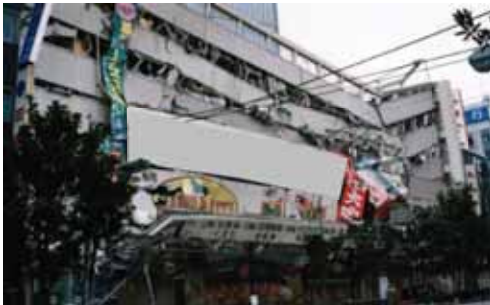
地震により崩壊した大規模店舗
