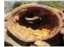
管路の老朽化が進行
