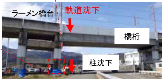
令和4年3月の福島県沖を震源とする地震による被害
