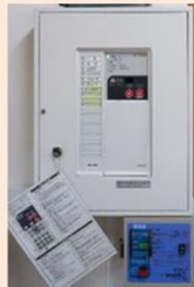
自動火災報知設備（受信機）
