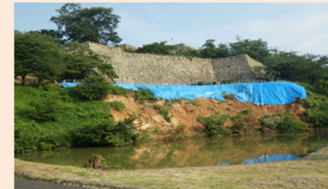
被災事例（史跡津山城跡） 城郭公園内の遊歩道下の法面が崩落。
