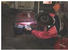
自家発電機により、SSの電力を確保し、 災害時における燃料供給に貢献
