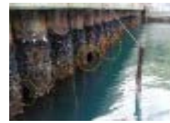
防波堤の老朽化
