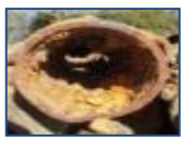
管路の老朽化が進行
