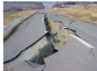
破損した農道（岩手県奥州市）
