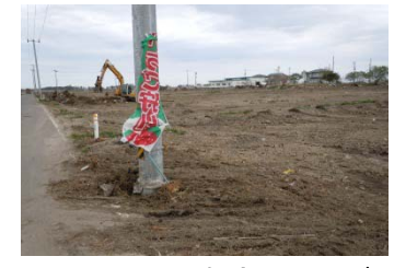
周辺のハウスも流出し、ガレキ・ヘドロ等が堆積
