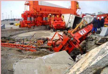
荷役機械の倒壊により荷役不能となった岸壁(仙台塩釜港)
