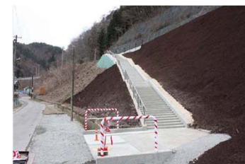
「避難階段」により児童が迅速かつ安全に避難(若手県岩泉町)
