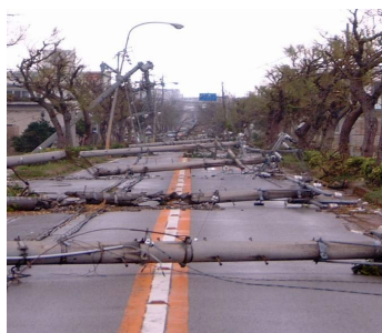
電柱の倒壊による道路閉塞
