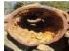
管路の老朽化が進行
