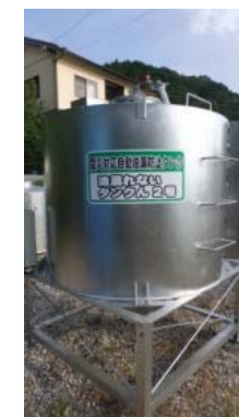
〔流出防止装置付き重油タンク〕
