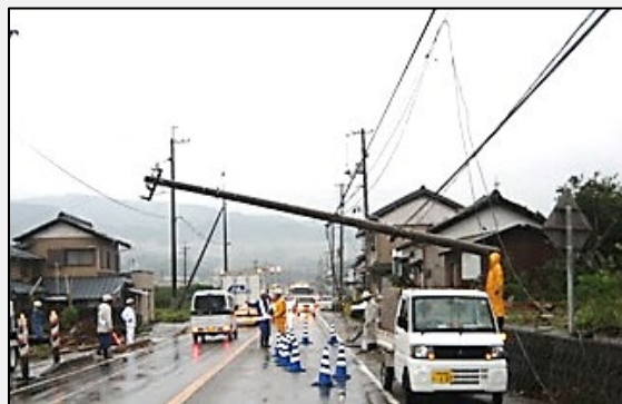
電柱が倒壊し、道路を閉塞した事例
