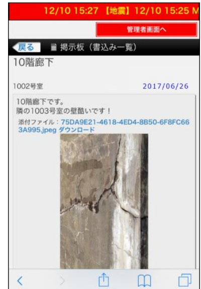
マンション内の被害状況を伝達
