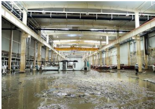
水害発生直後の様子
