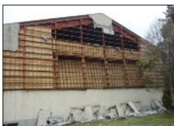
外壁の全面的な脱落事例
