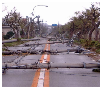
電柱の倒壊による道路閉塞
