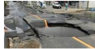
地震による管路の被災状況
