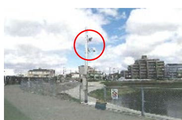
監視カメラの設置
