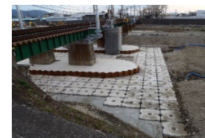
鉄道橋りょうの流失・傾斜対策
