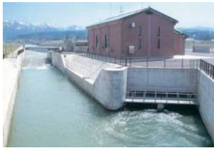
農業用水路を活用した小水力発電施設
