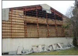
外壁の全面的な脱落事例
