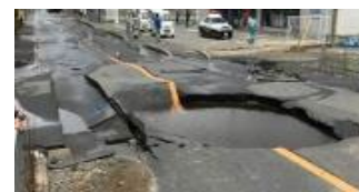
地震による管路の被災状況
