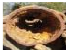
管路の老朽化が進行
