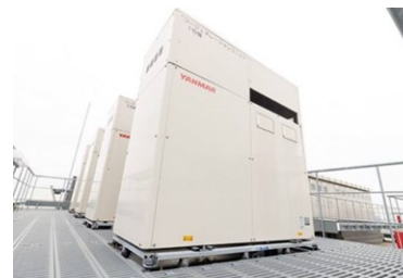
停電対応型ガスコージェネレーションの活用例
