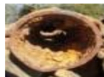
管路の老朽化が進行
