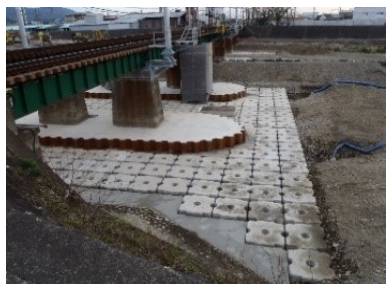
鉄道橋梁の流失・傾斜対策
