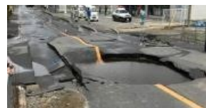
地震による管路の被災状況
