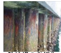
防波堤の老朽化
