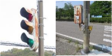
老朽化した交通安全施設
