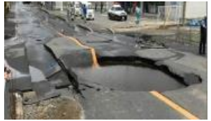
地震による管路の被災状況
