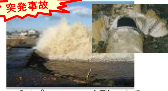
パイプラインの破裂による用水供給機能の停止
