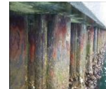
防波堤の老朽化
