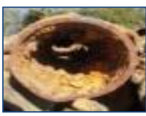
管路の老朽化が進行
