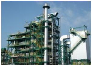
木質バイオマス発電所
