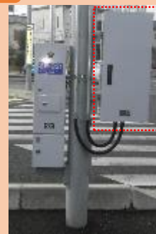
信号機電源付加装置 (リチウムイオン電池式)
