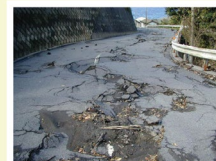
平成12年 路面損壊
