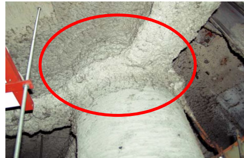
付着した綿状の物質が吹付け石綿
