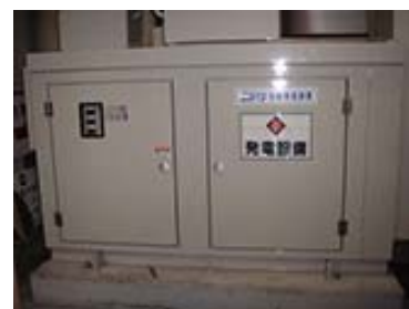
【物流施設における自家発電装置】
