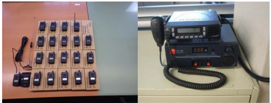
【整備した防災無線】
