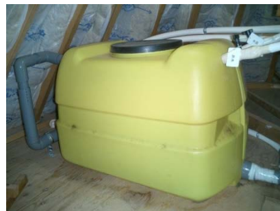
【屋根裏に作った地下水タンク】
