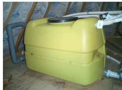
【屋根裏に作った地下水タンク】
