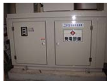
【物流施設における自家発電装置】
