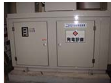
【物流施設における自家発電装置】
