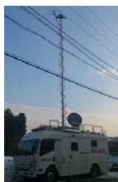
【移動基地局の設置】
