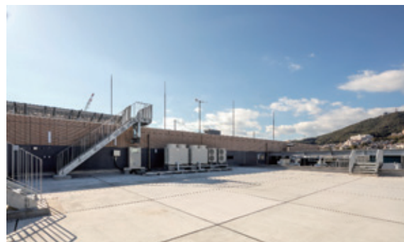
災害時における警察機能維持のため、受変電設備等を屋上へ設置
