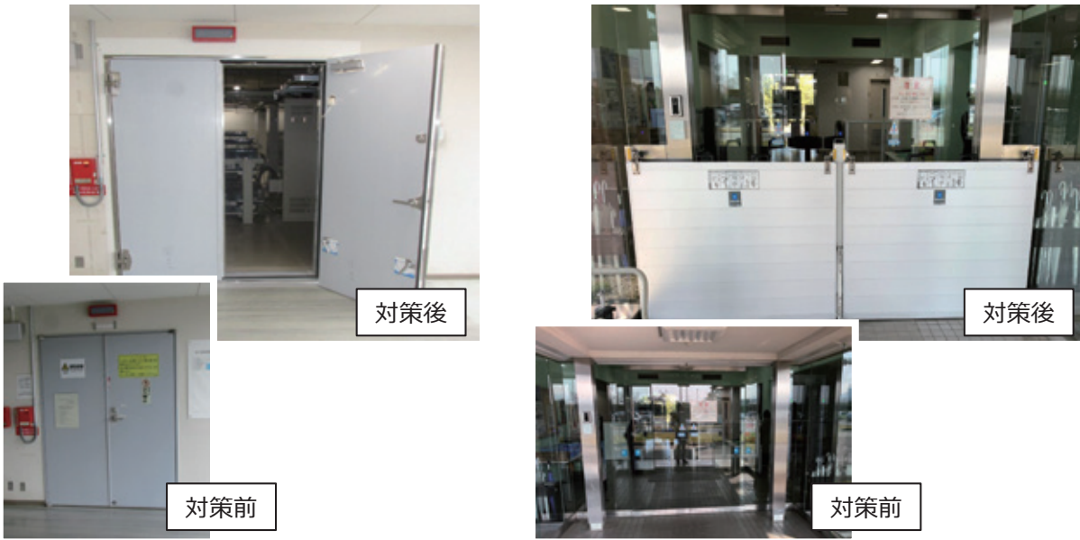
電源設備等が設置された部屋に止水扉や止水板を設置
