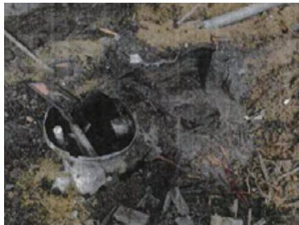
風水害による破損のリスク
