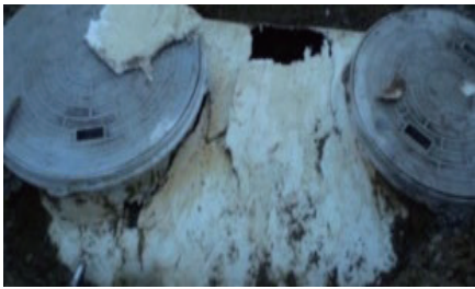
老朽化している単独処理浄化槽
