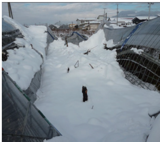
農業用ハウスの補強対策未実施
