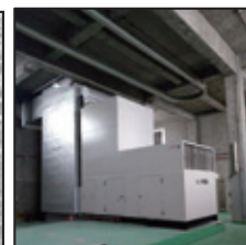
非常用発電設備
