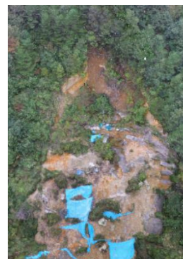
法面崩壊直後
