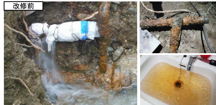
腐食により給水管が破損したり、給水管内部の発錆により赤水が発生
