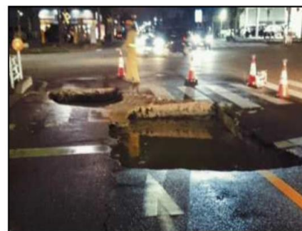
下水道に起因した道路陥没
