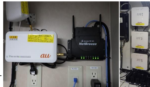
陸上が停電しても稼働するau基地局と船内定額ネット回線(NetBreeze)
