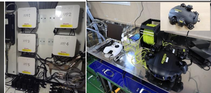
無停電docomo基地局で本船周辺に電波を提供
