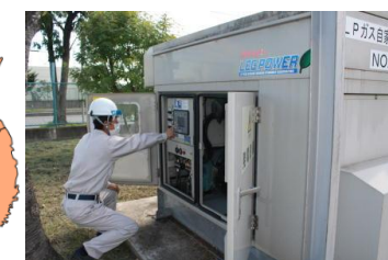
本事業によって整備した非常用発電機
