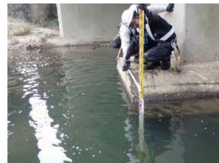
最大1.1mの洗掘を確認
