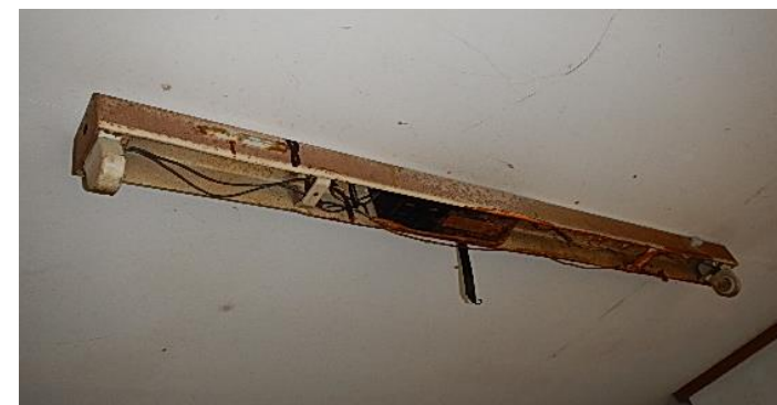
廃墟にて発見されたPCB使用安定器の例
