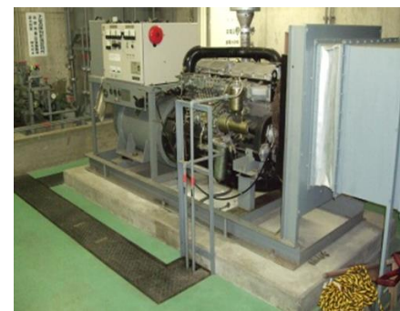
自家発電設備（改修前）
