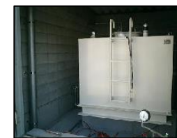
災害備蓄用石油タンク
