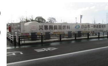
災害備蓄用LPガスタンク
