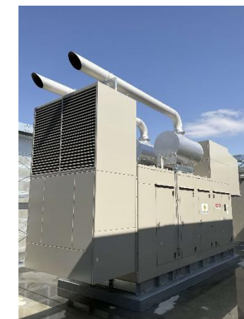
非常用自家発電設備(拡大)
