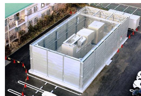
非常用自家発電設備(全景)
