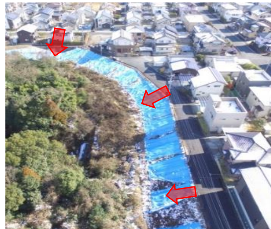
平成28年熊本地震により発生した造成宅地の滑動崩落
