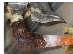
配管の腐食による漏水の発生
