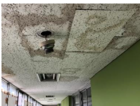
雨漏り等による内装材の劣化
