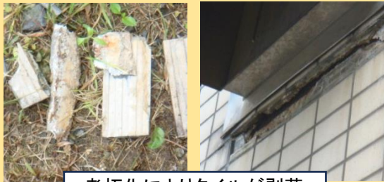
老朽化によりタイルが剥落
