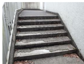
避難導線となる屋外階段の劣化
