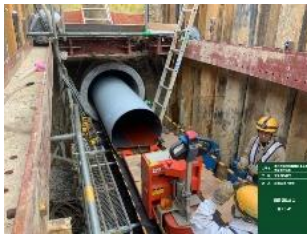
既設管の中に耐震性のある鋼管を挿入するPIP（パイプインパイプ）工法の実施
