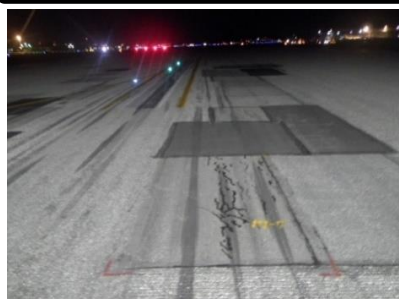
老朽化した滑走路舗装
