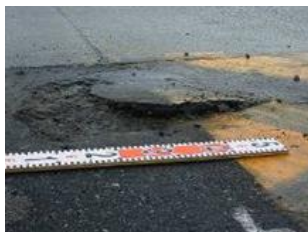
老朽化した舗装の剥離
