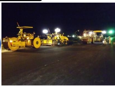
老朽化した滑走路舗装の改良
