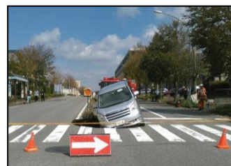
道路陥没による通行止め
