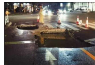
下水道に起因した道路陥没
