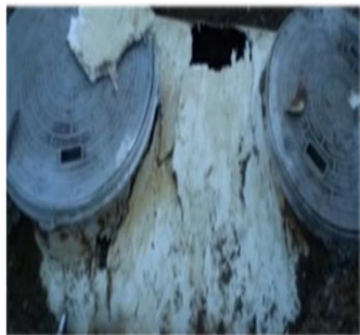
老朽化している単独処理浄化槽
