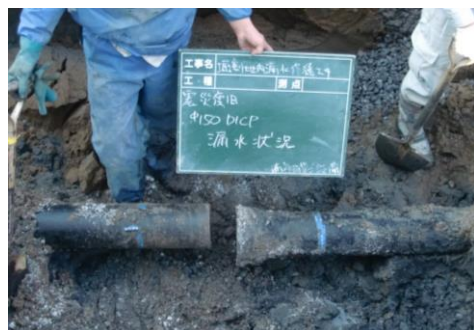
東日本大震災被害状況
