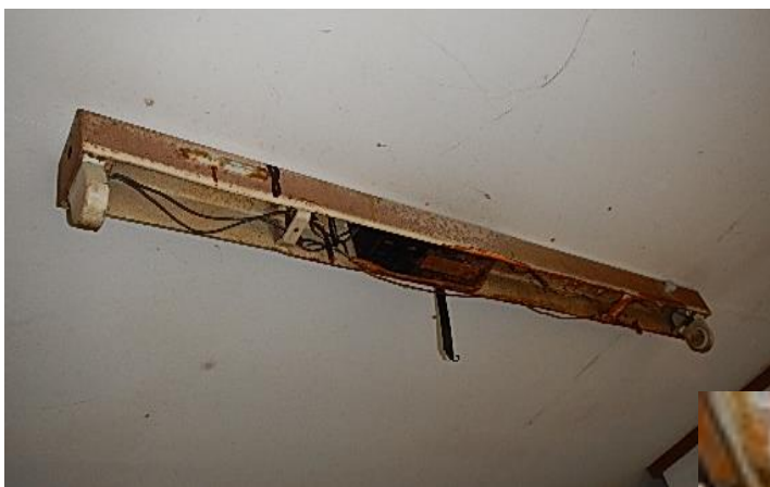
廃墟にて発見されたPCB使用安定器
