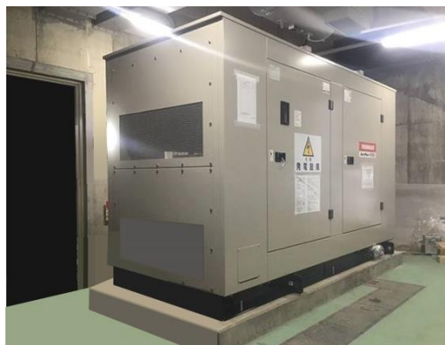
自家発電設備 改修後
